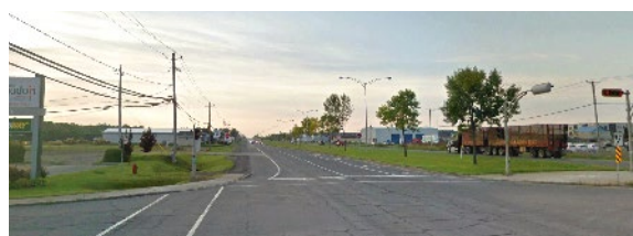
FIGURE 8 Discontinuité du trottoir sur la route Kennedy
